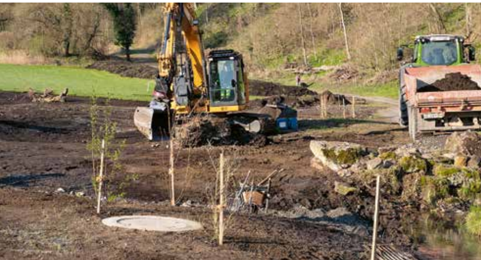
Für die Modellierung der Warm- und Kaltwasserzonen der Feuchtfläche wurden 1200 Kubikmeter Humus und Torf abgetragen und auf den benachbarten Feldern zur Bodenaufwertung ausgetragen. Lehmiges Material fand bei den Wasserflächen als Abdichtung Verwendung.
